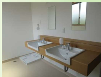
洗面台は各階に2台設置してあります
